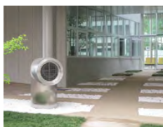
室外のクールチューブ(吸込み)
