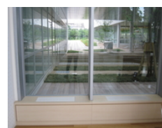
室内のクールチューブ(噴出し)
